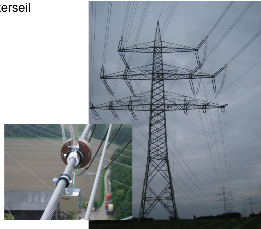
Feldversuch an 380kV Leitung
